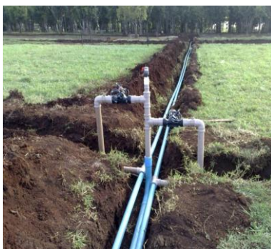
Figura 8: Sistema automatizado de irrigação
